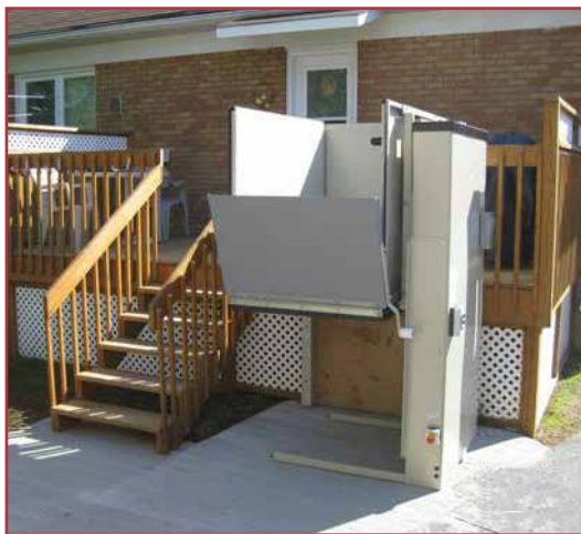
Plate-forme élévatrice extérieure
