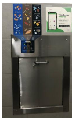
Chute à déchets à trois voies
