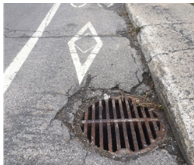
Puisard dans la bande cyclable sur la rue Belleau et état de la chaussée
