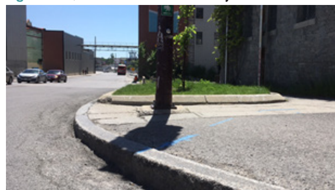
Absence d'abaissée à l'intersection Eddy-Laurier
